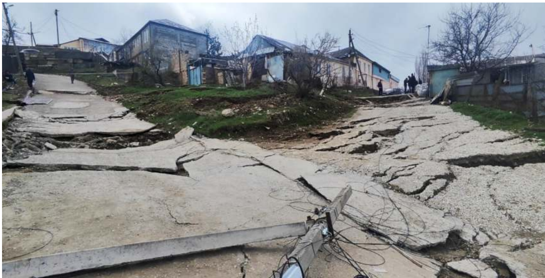
Рис. 1. Растрескавшееся дорожное полотно на оползневом участке в городе Буйнакске (Республика Дагестан)
